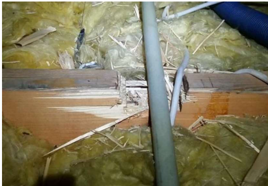
podcięty przez instalatorów pas dolny wiązara, fot. Tomasz Nowak
