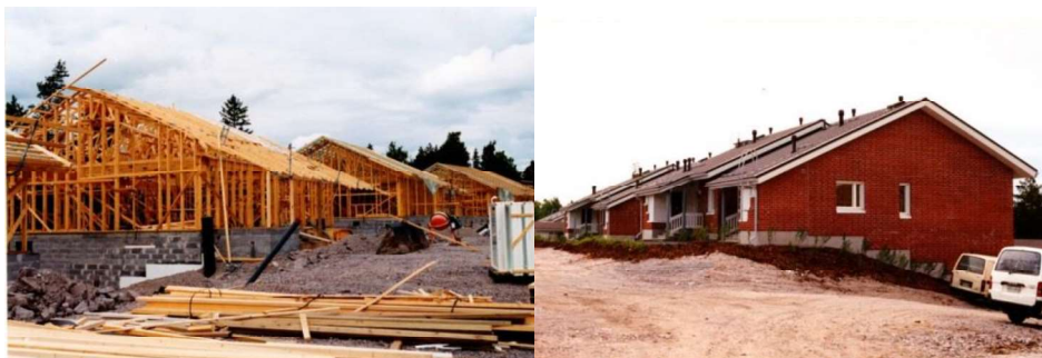
Domy szkieletowe o konstrukcji z drewna litego, klejonego warstwowo i LVL oraz stropach wykonanych z zastosowaniem belek dwuteowych. fot. Ewa I. Kotwica, źródło [31]
