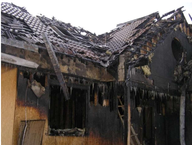
Zniszczenia spowodowane pożarem podczas budowy domu wykonanego w technologii szkieletu drewnianego fot. T. Wiśniewski)
