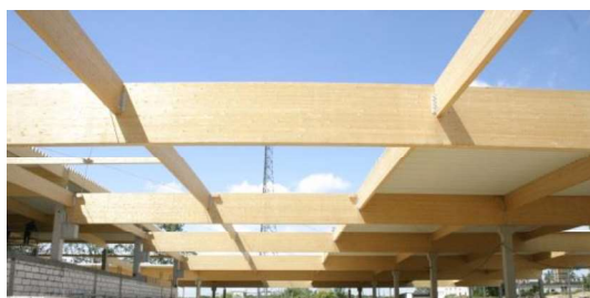
hale produkcyjne i magazynowe, fot. Ewa I. Kotwica
